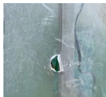
写真2 慣行区 ハウスビニールの破損
