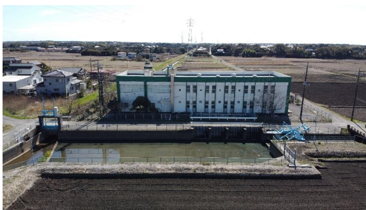
<新宿揚水機場>
