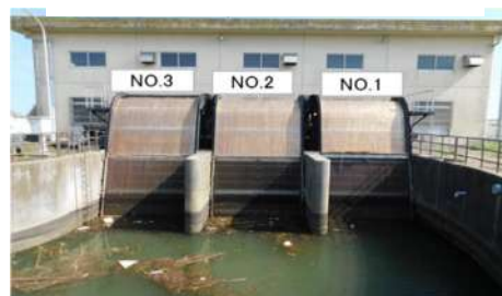
除塵機設備(全景)
