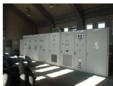
四天木揚水機場電気設備
