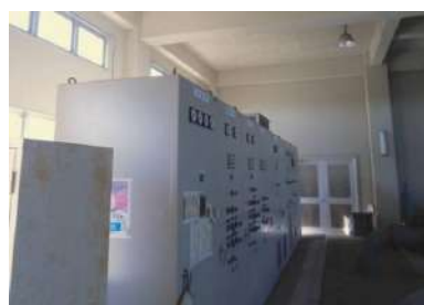
細草揚水機場電気設備
