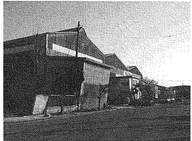
鉄鋼団地 倉庫が大きく傾いている
