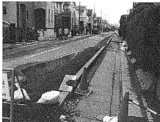
舞浜 道路中央が相対的に高くなり，両脇が数十cm沈下している。両脇の戸建て住宅とレンガ塀は数十cm程度沈み込んでいる。電柱は沈降し傾いている。
