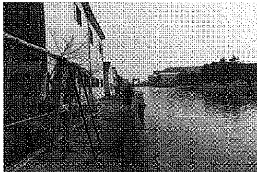
口絵写真-8 船橋市栄町で発生した護岸の孕み 出しと背後地盤での被害
