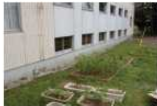
入船中学校武道棟(摩擦杭、地盤改良なし) 中学校校舎に対して約80mm沈下
