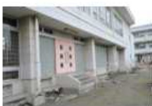
屋内運動場棟(摩擦杭、地盤改良なし) 小学校校舎に対して42-66mm沈下
