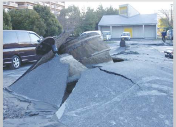
液状化によるマンホールの浮き上がり (浦安市高洲)
