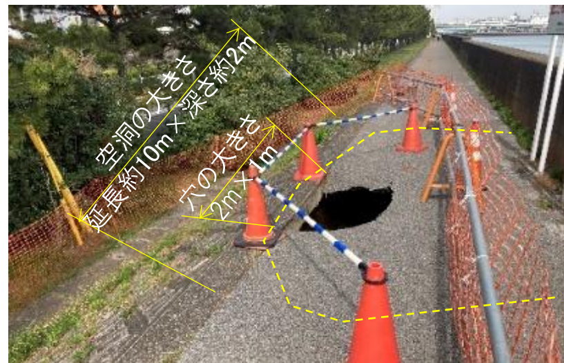
陥没発生状況
