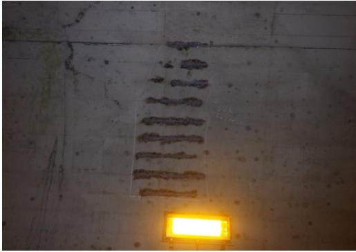
鉄筋が露出しています。
