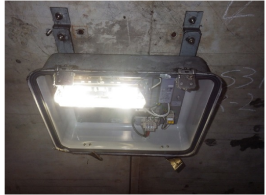
照明灯具本体が破損しています。
