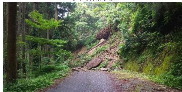
法面崩落状況
