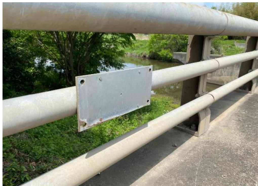
発生箇所 神崎橋 (盗難発生後)
