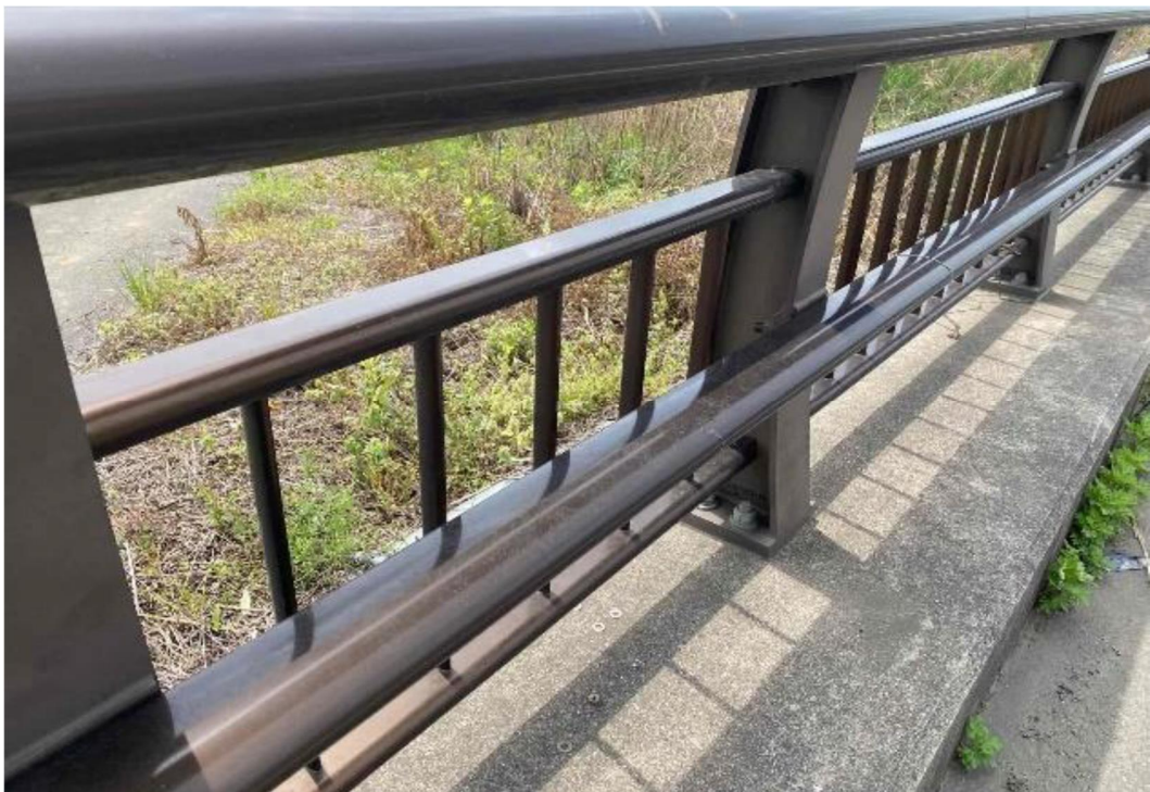
発生箇所 阿宗2号橋 (盗難発生後)
