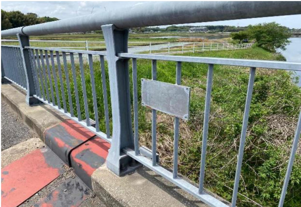
発生箇所 新阿宗橋 (盗難発生後)
