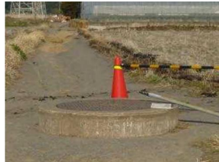
人孔（マンホール）の浮上
