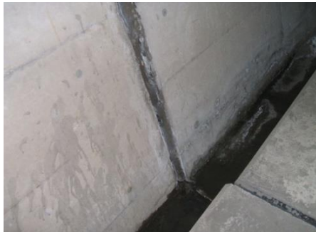
処理施設の躯体のずれ
