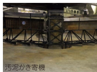
水処理設備の更新
