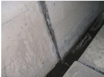
処理施設の躯体のずれ
