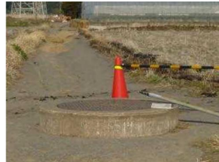
人孔（マンホール）の浮上
