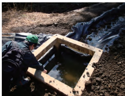
定期検査における排水のpHの確認
