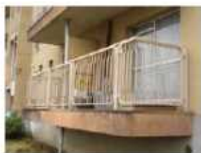
バルコニー手摺の改修前
