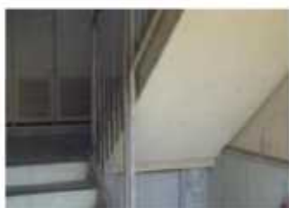
階段手摺の改修前
