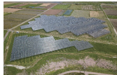
写真：匝瑳メガソーラーシェアリング 第 1 発電所
