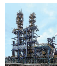
(2)CO 2 分離・回収設備
