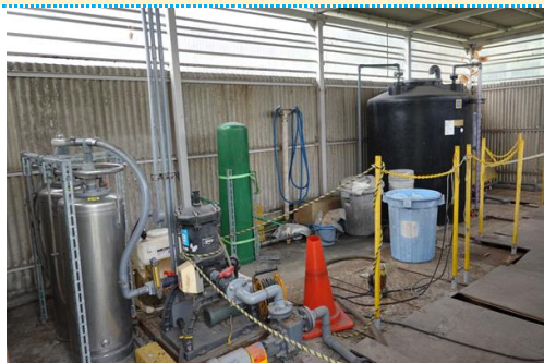
排水処理施設
