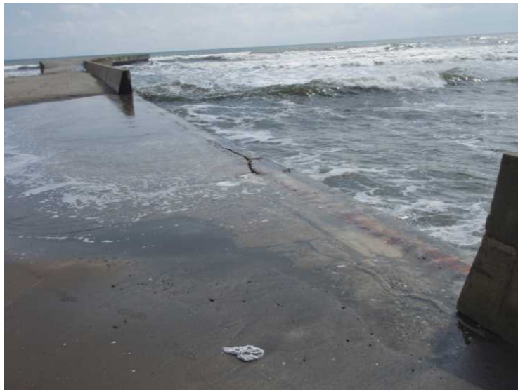
■ 河口左岸の護岸堤防倒壊
