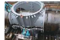
木下取水場(印西市)
