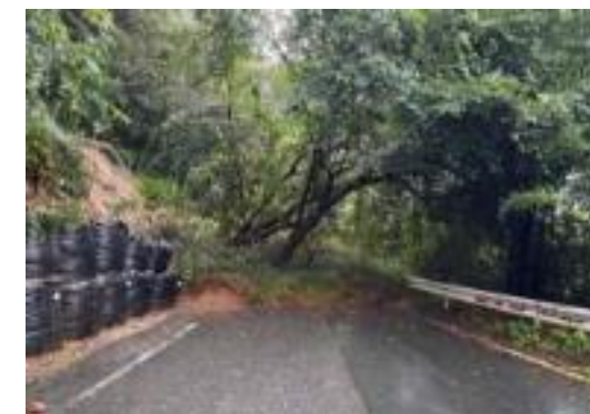
土砂崩れ、道路の寸断
