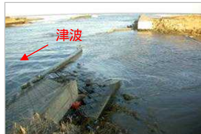
津波による堤防決壊(二)木戸川
