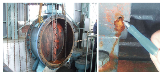
劣化した部品の例
