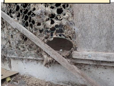
金網や防鳥ネット等の破損
