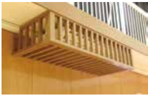
学校体育館の空調設備の設置例
