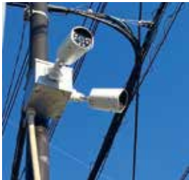
県補助金を活用した防犯カメラ(令和6年度)
