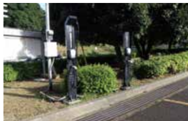
設置例 県立房総のむら駐車場
