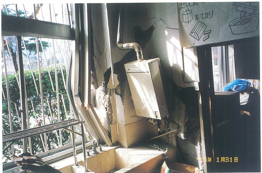
▲ ガラスが飛散し、曲がった窓枠と一部損壊したガラス器具
