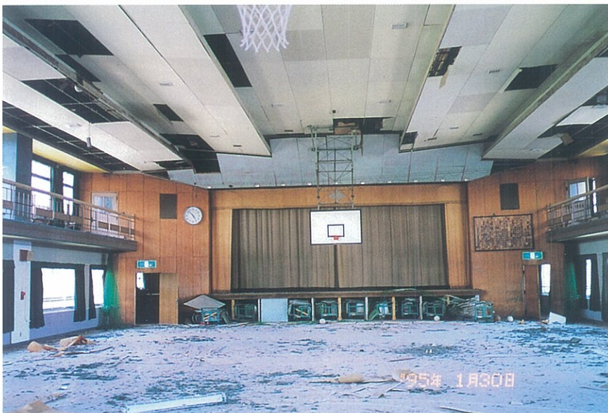
◀天井板や蛍光灯等が落下 散乱した体育館
