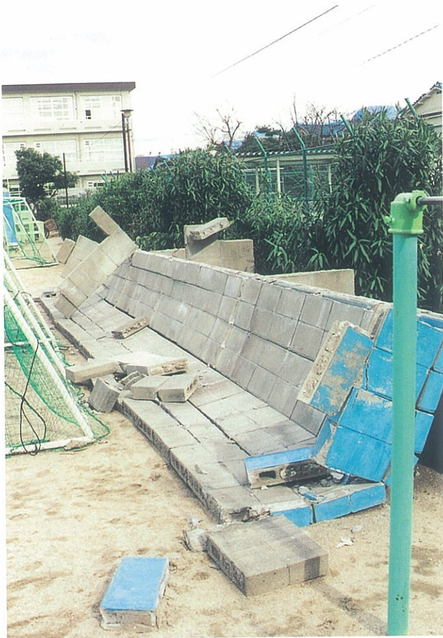
◀ 倒壊した校庭のブロック塀
