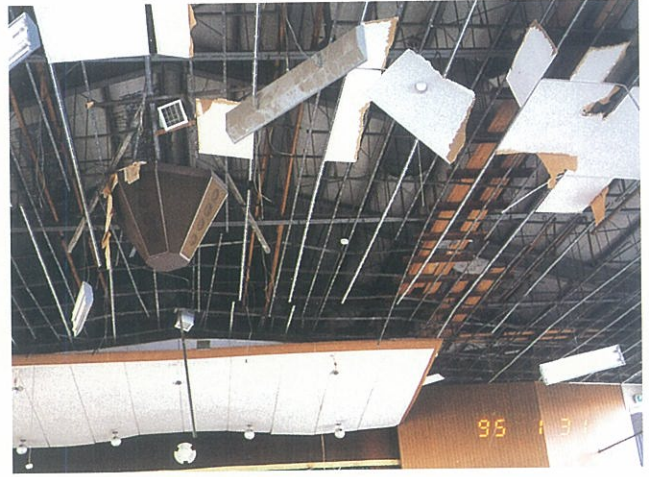
▲ 天井板が殆ど落下し、骨組みがむき出しの体育館
