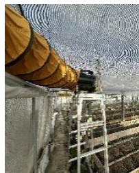
外気導入 ダクトファン
