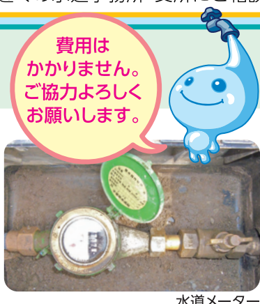
水道メーター
