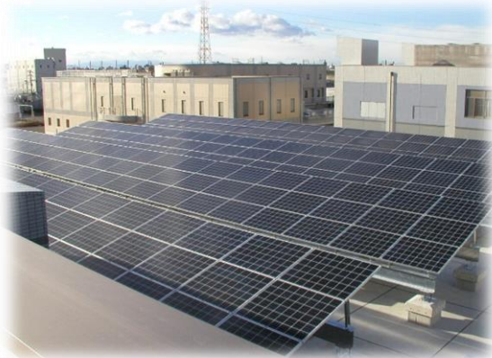
ちば野菊の里浄水場太陽光パネル
