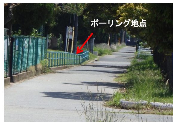
図 2 ボーリング地点付近の手すりが湾曲している状況。
